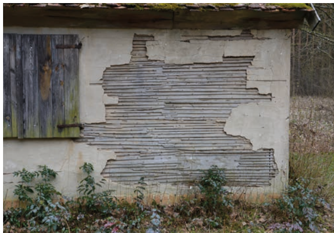
Na zniszczonym budynku w okolicach Prądówki widać dawne metody budownictwa
